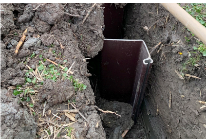
Ein Dachs hat den Damm beim Möwenteich durchgraben: zur Reparatur des Damms wurde eine neue Spundwand gesetzt. (Fotos S. 3: Pro Natura SGA)
