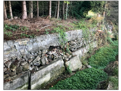
Zerfallende Uferverbauung des Baches mit verbauten Altlasten.
